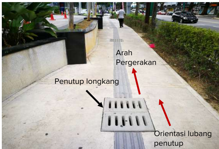
Foto 4.4: Contoh orientasi penutup longkang/penutup saluran air hujan yang salah
