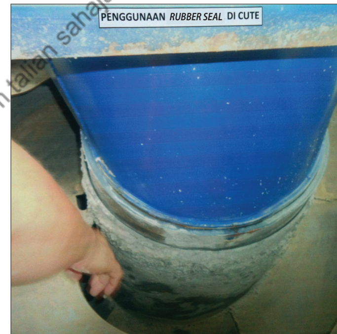
Contoh menunjukkan bagaimana pelekat getah dilekatkan pada corong buyong bagi mengelakkan tumpahan simen sewaktu lori simen menaiki bukit atau melalui bonggol yang tinggi
