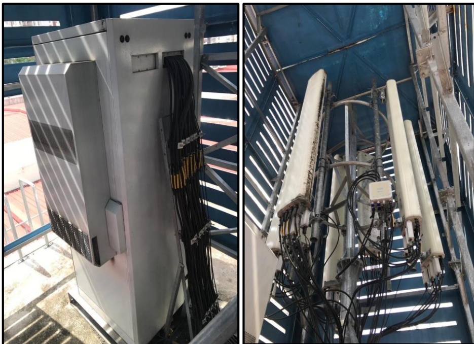
Pandangan Dari Dalam Struktur Telekomunikasi Yang Terlindung / Camouflage
