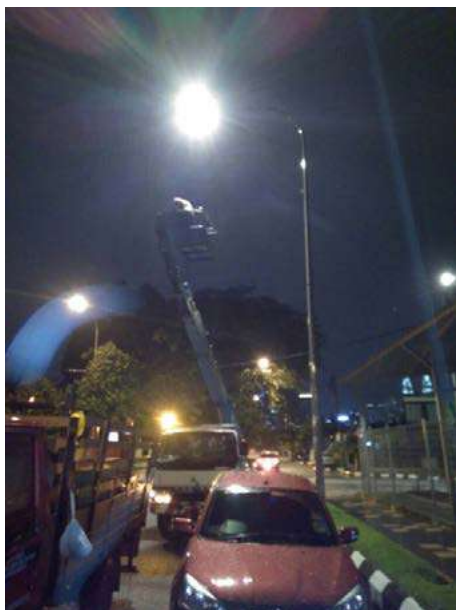
Lampu Jalan HPSV
