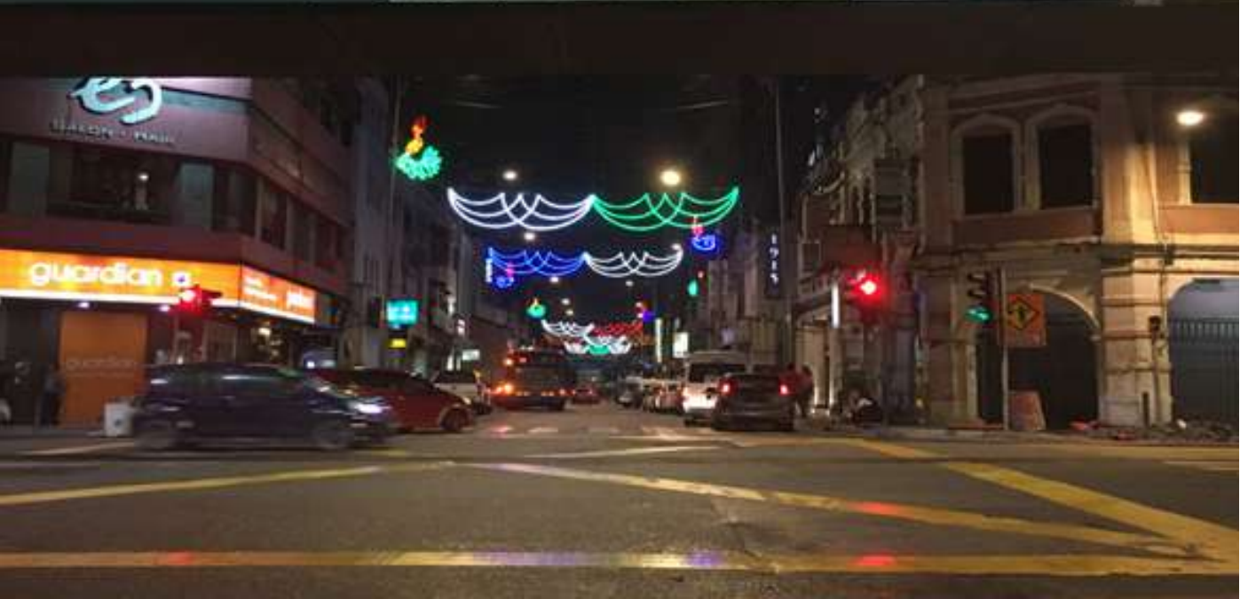
Pemasangan Lampu Hiasan LED, Motif Merak dan Pelita sempena Deepavali 2018
