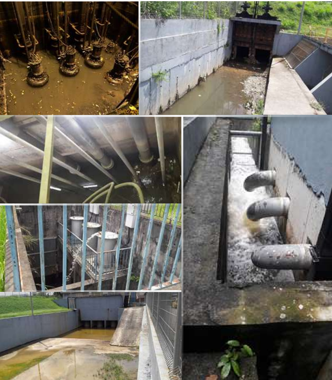
Rumah Pam Kawalan Banjir
