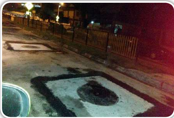
JALAN PEEL - TENAGA NASIONAL BHD BHD.
