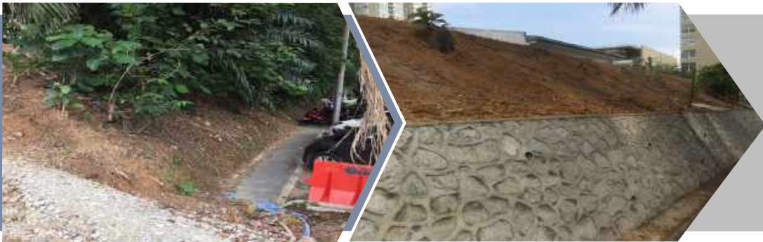
Kerja-kerja pembaikan cerun dan kerja-kerja berkaitan di Jalan Senuduk, Taman SA, Kuala Lumpur
