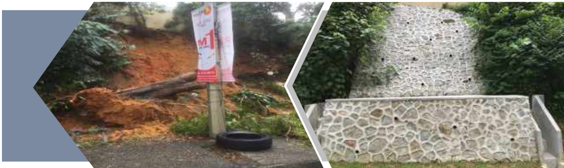
Kerja-kerja pembaikan cerun dan kerja-kerja berkaitan di Jalan Pantai Murni, Pantai Hillpark, Kuala Lumpur
