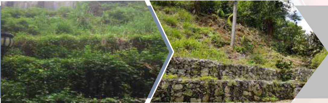
Kerja-kerja pembaikan cerun dan kerja-kerja berkaitan di Lorong Badang 5, Bandar Baru Sri Petaling, Kuala Lumpur
