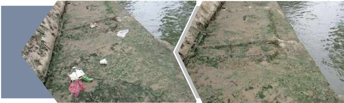
Mopping Up di Sg. Kelang Dari Masjid Jamek hingga ke jambatan Bandar Baru Sentul
