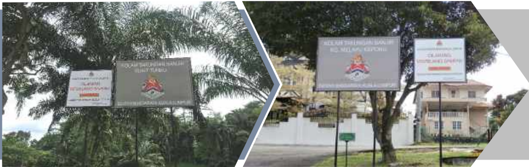
Kerja-kerja memasang papan tanda nama dan amaran di semua kolam takungan banjir
